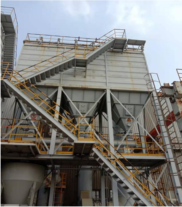
三磨废气处理设施进口监测
