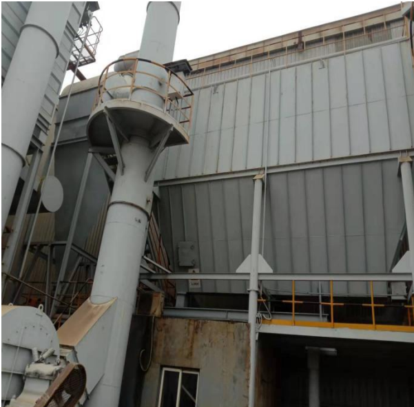
喷锌废气处理设施
